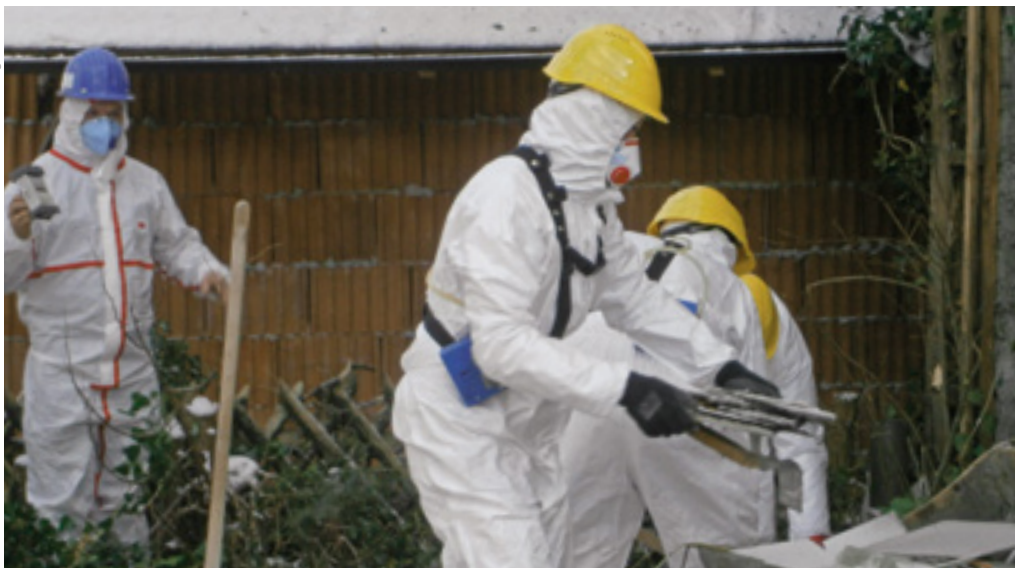
Gefahr durch Asbest: Aufgrund ihrer Beständigkeit und nadelförmigen Gestalt können sich Asbestfasern dauerhaft in der Lunge einlagern und so später Krebs auslösen.
